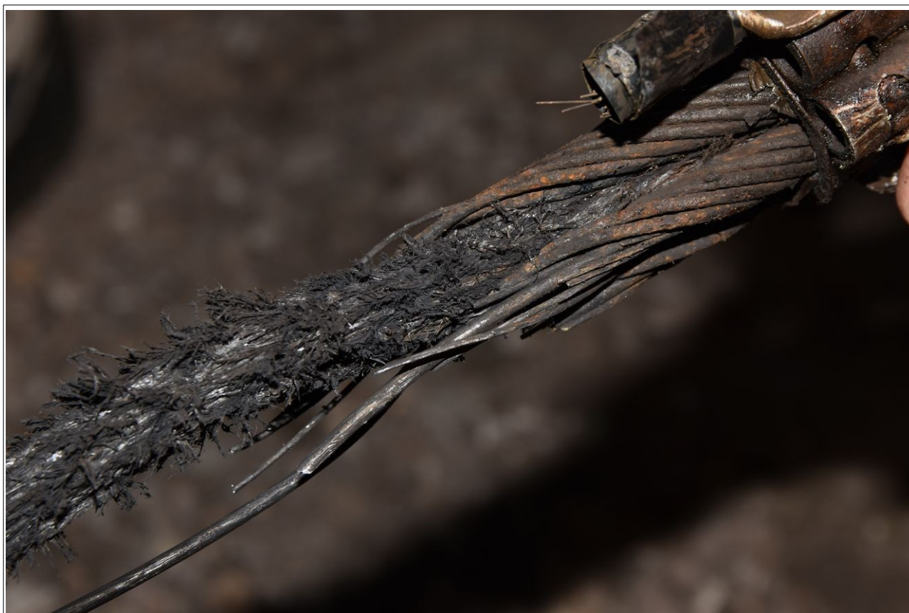
Obr. č. 5: Přetržený konec tažného lana nalezený 55 m od horní stanice
